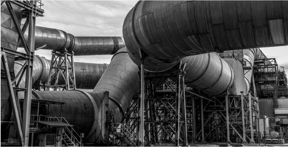
Parte de la instalación de la planta de desulfuración de gases. Foto: Carlos Colás
