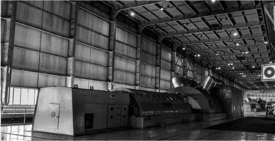
Interior de la nave de turbinas. Foto: Carlos Colás
