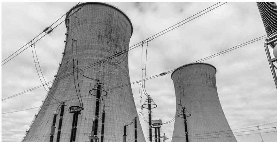
Las torres de refrigeración. Foto: Carlos Colás
